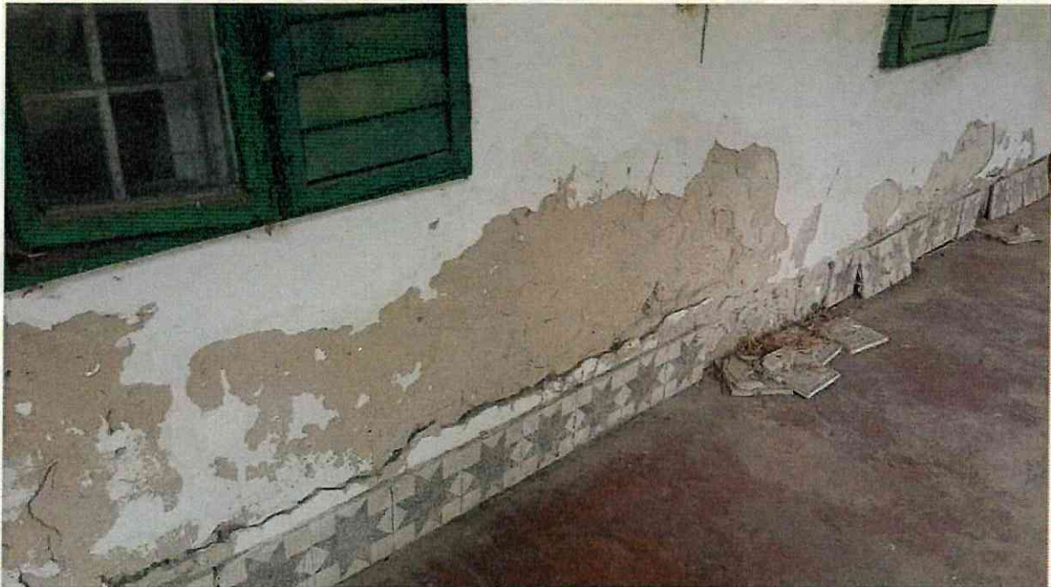
Repedések a lábazon, vizesedés nyomai a falakon
