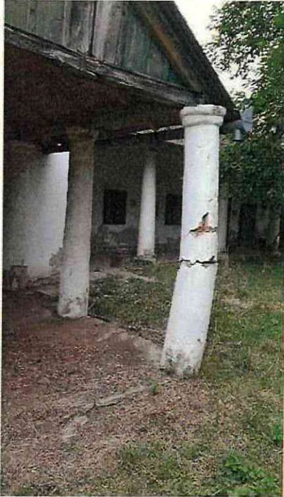
Teljesen elrepedt, nagyon rossz állapotban lévő pillér
