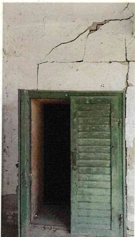
Nyílás feletti repedés, az áthidalás teljes mértékben körül repedt, valamint ferde repedések is megjelentek az épületen
